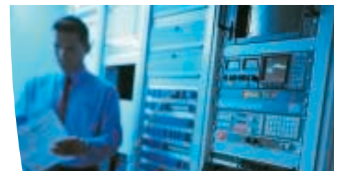
Intégration dans les racks haute densité.
